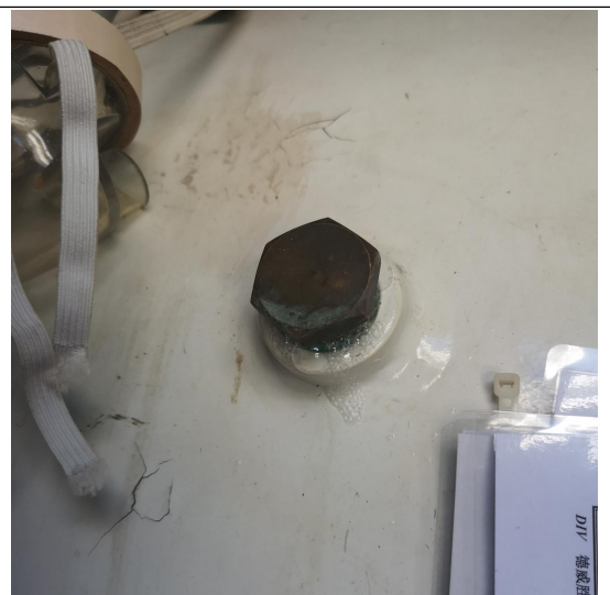
图 18 微渗漏 (测量时气泡水抹干净)
